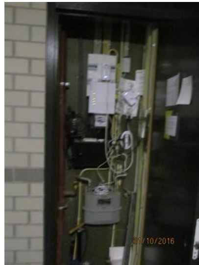
Foto van de meterkast
